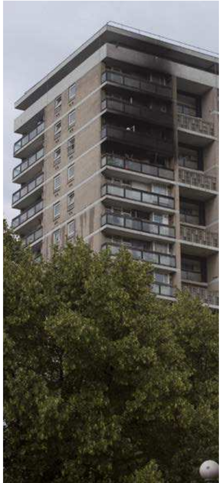
Rayo impacta en edificio residencial. Londres (Reino Unido).
