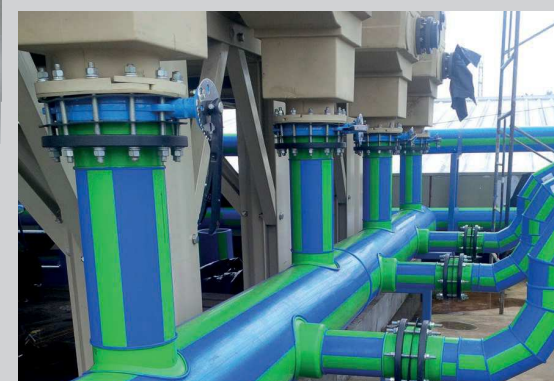
Colector de distribución
