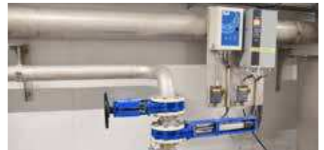
Válvulas de guillotina AVK con actuadores lineales en una tubería de agua de rechazo. Se eligieron los actuadores lineales, ya que son energéticamente eficientes en comparación a los actuadores que utilizan aire comprimido.
