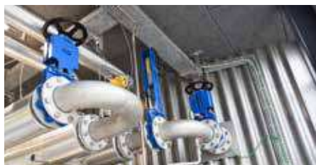
En el tanque de digestión, el lodo se recircula a través de un intercambiador de calor.
