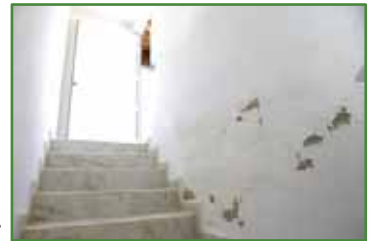
Ejemplo de humedad por capilaridad ascendente.
