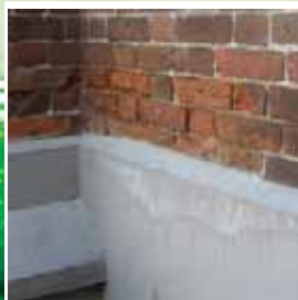
Humedades por capilaridad
