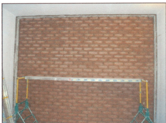
Fotografía 1 Pared sin revoque
