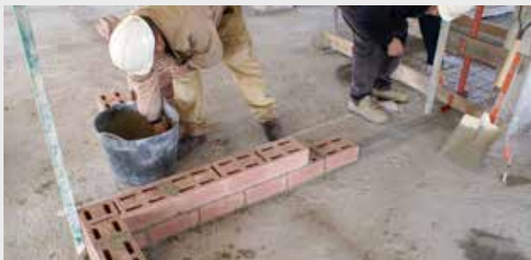
Arranque directo de forjado. Sin bandas.
