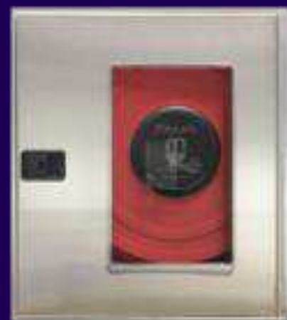
RED DE BOCAS DE INCENDIO EQUIPADAS
