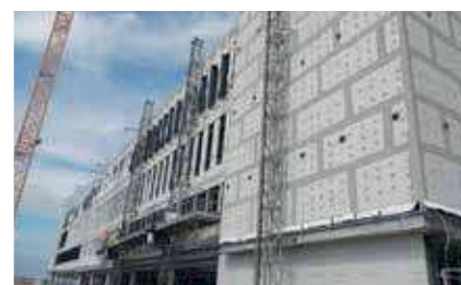
Sede de Cajamar. Almería
