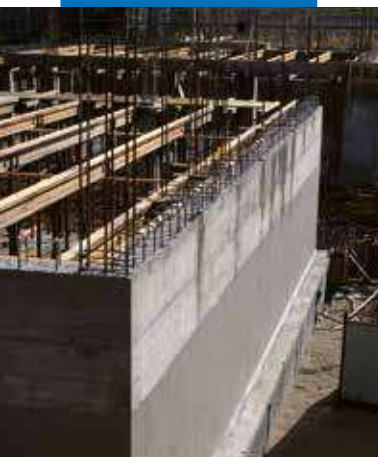
Muro de contención de tierras impermeabilizado después del hormigonado con Mapelastic Foundation
