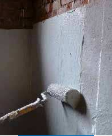
Aplicación de Mapelastic Foundation a rodillo, sobre soporte previamente regularizado con Planitop HDM Maxi
