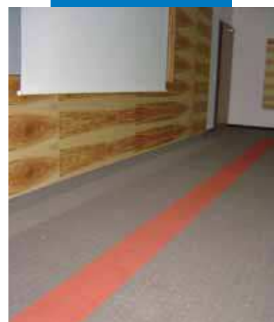
Ejemplo de uso de Primer G antes de la colocación de Ultraplan Eco y del adhesivo Rollcoll , para el encolado de la moqueta en las habitaciones del hotel - Villa Hotel Castellani - Austria
