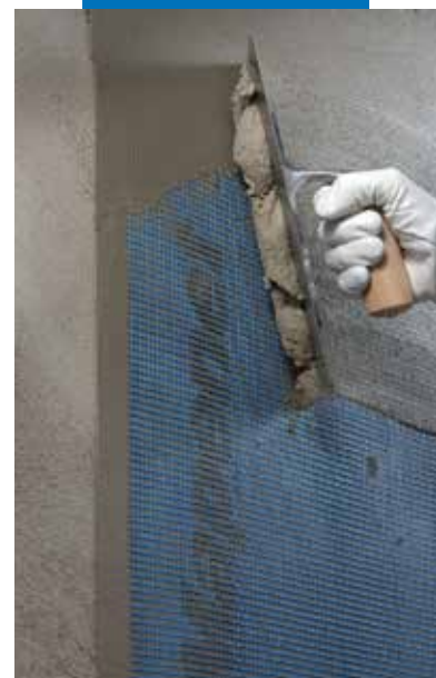
Aplicación de la segunda capa de Planitop 200 con interposición de la malla Mapenet 150 sobre soportes de diferente naturaleza
