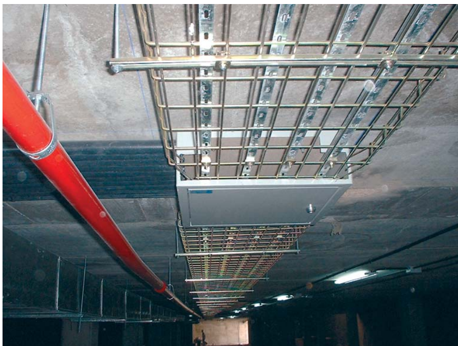
Rejiband instalada con tabique separador.
