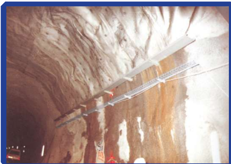
Zona del ensayo de incendio, con la lámina de impermeabilización y dos modelos de bandejas porta-cables instalados.
