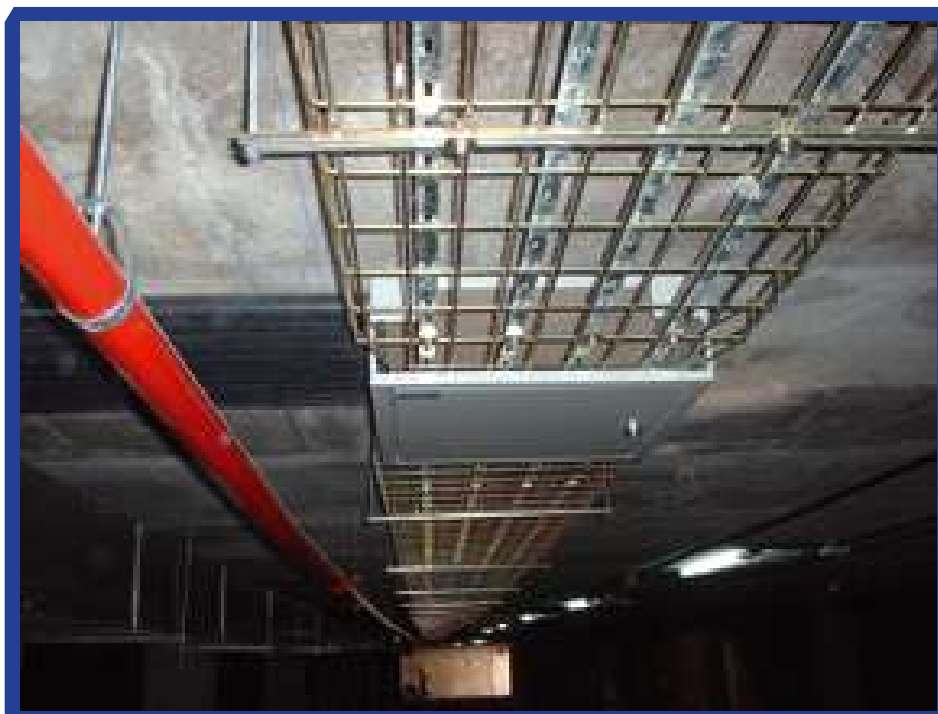
Rejiband instalada con tabique separador.
