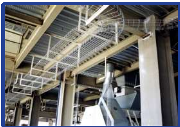
Rejiband en instalación industrial.
