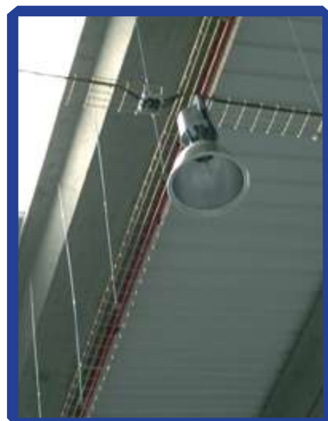
Bandeja Rejiband en techo.
