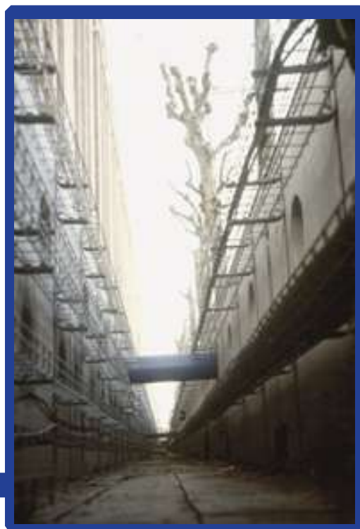
Rejiband en Galería Registrable.
