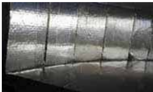
Interior de un codo curvo realizado por tapas (mayores pérdidas de carga).
