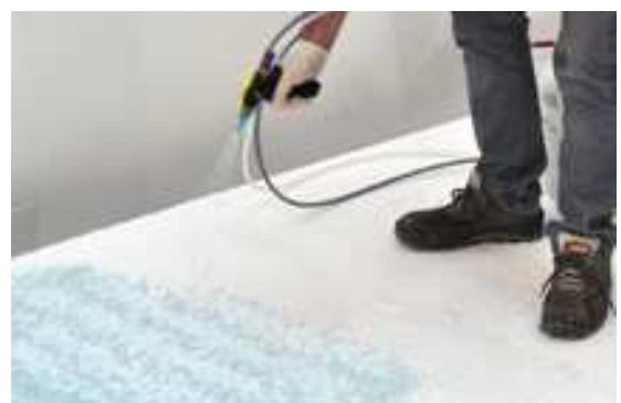
Fig 2: El adhesivo 81065 se pulveriza en el soporte a través de la pistola aplicadora
