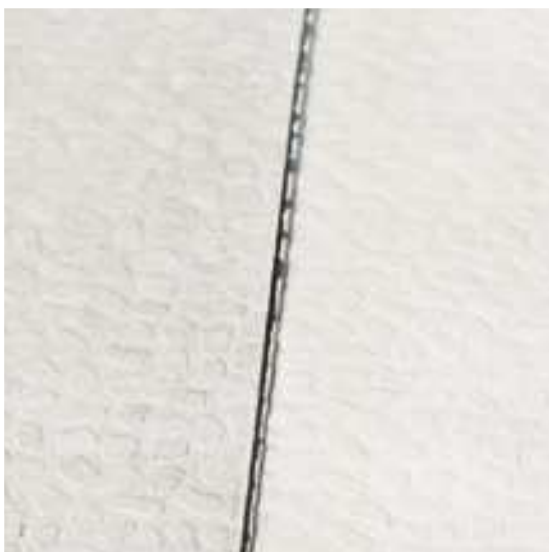
En el caso de las membranas de estanqueidad con capa inferior gris o negra, las soldaduras son muy visibles.
