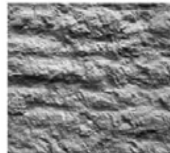
CSP 9 (Escarificado intenso)
