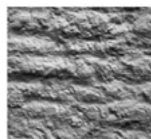
CSP 9 (Escarificado intenso)
