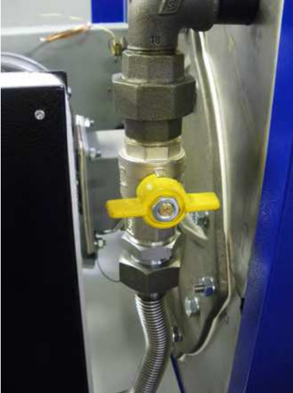
Figura 8.1.1 - Válvula de gas
