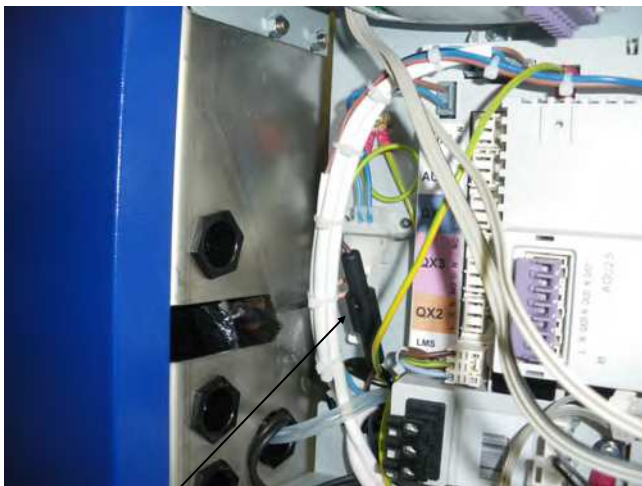
Figura 11.4 Fusible en línea
