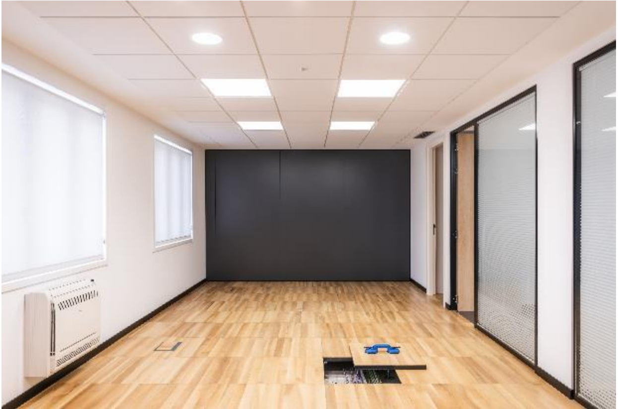
(Detalle de suelo técnico elevado en las nuevas oficinas del INE en Lugo con revestimiento en madera. Foto Javier Bravo©)
