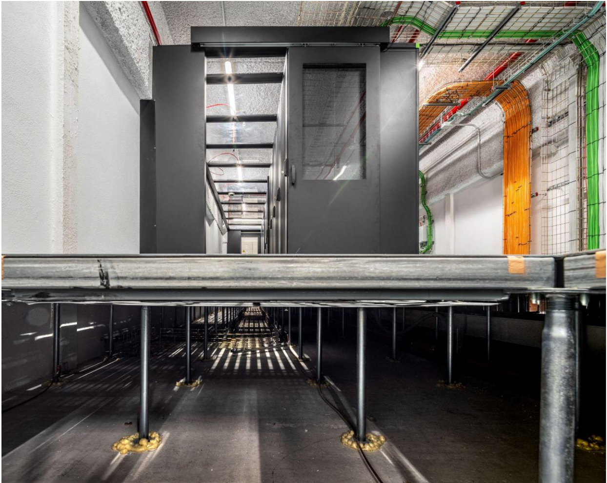
(INTERIOR SALA TÉCNICA)
